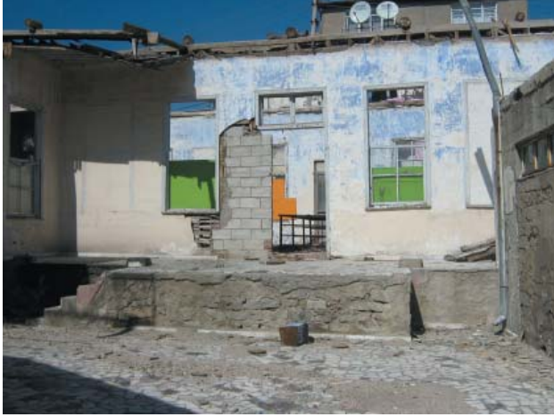
Levha-550: Keçeci Mahallesi 2316 Sokak'ta bulunan evin (Katalog 109) karşılıklı merdiven basamakları (sađ tarafta olan merdiven yıkılmıştır).
