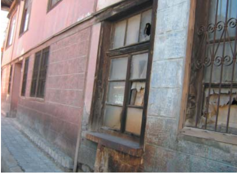
Levha-744: Turan Mahallesi Hallaç Sokağı 10 ve 12 numaralarda bulunan evlerin zemin katlarının yan yana görünümü.
