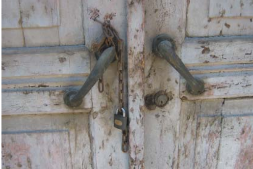
Levha-450: Gazi Kemal Mahallesi, 1308-1310 sokak, No: 70'deki evin çapraz takılmış yassı kapı kolları.
