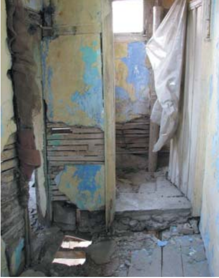
Levha-324: Eyüp Bey Evi'nde (Katalog 125) tuvalet yapısı dışarıya taşkınlık yapmaktadır.
